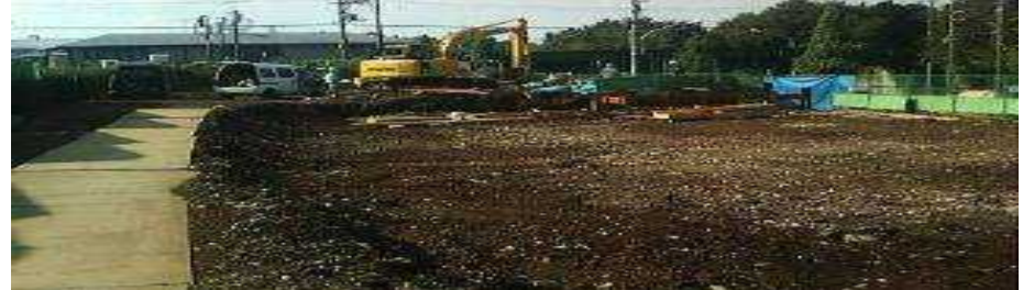
二枚橋に接する30メートル道路(東京 八王子道路)の府中市の土地では保育所建設が進んでいる。
